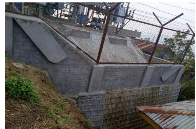
RRM Wall 33/11 kV Botsa S/S
