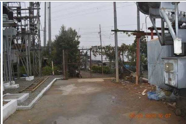
33/11 kV ITI, Kohima S/S Gate
