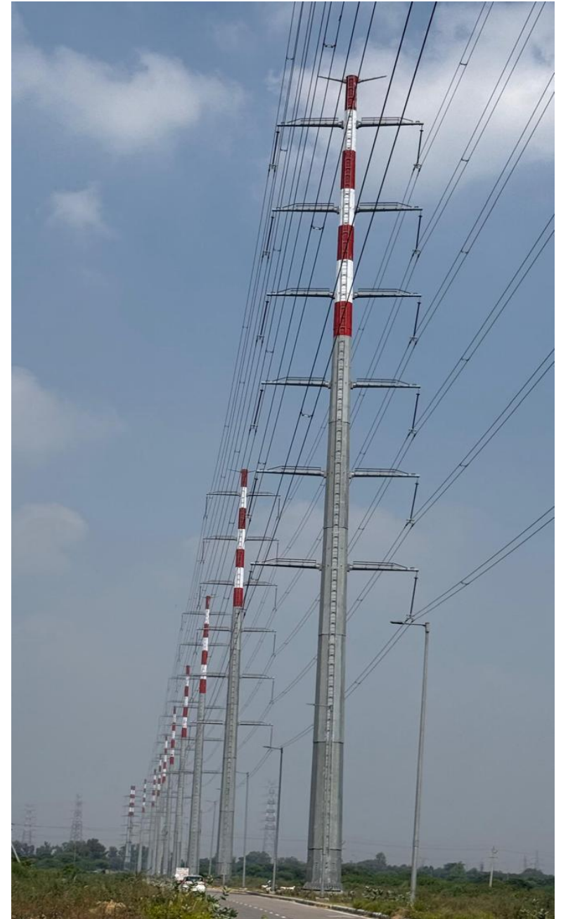
Actual picture - Monopole Towers
